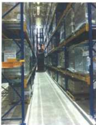
Die Fachlast des Palettenlagers kann bis zu 1,6 t betragen
